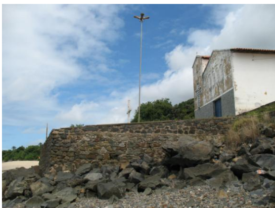
Fig. 12. Muro de contenção a frente da capela. Foto: Fabiana Comerlato. Data: 27/10/2008.
