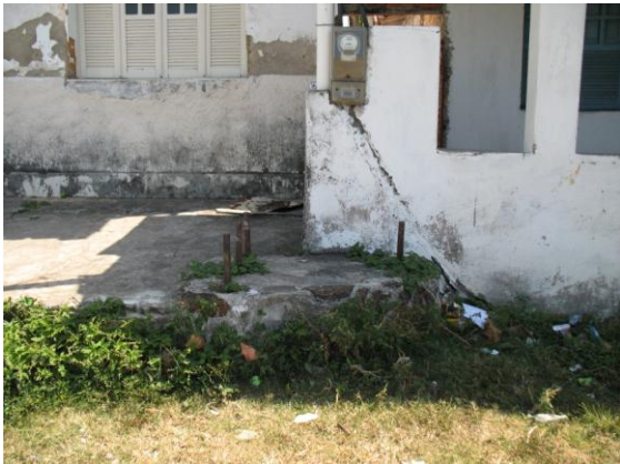
Fig. 16. Estrutura remanescente na lateral da calçada da escola municipal de Manguinhos. Foto: Fabiana Comerlato. Data: 27/10/2008.
